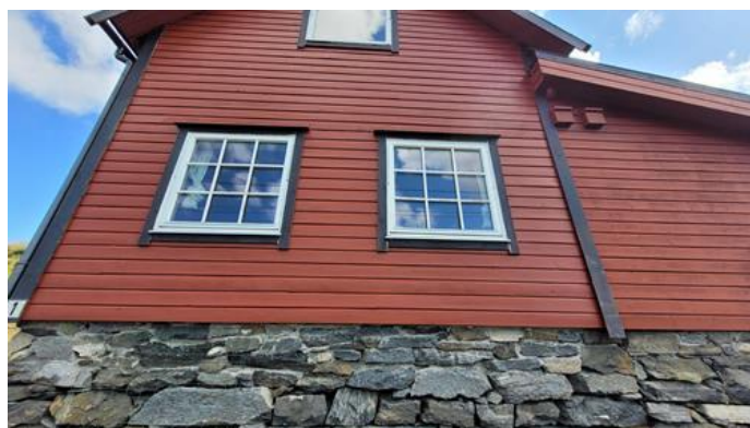
Utvendig - [Fasade har preg av slitasje.]
