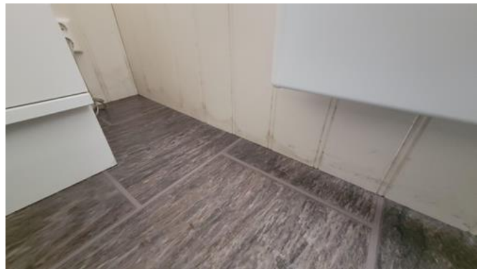
Øvrige rom [eksklusive spesialrom] - [Skade på vegg soverom.]
