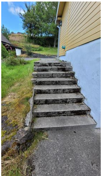
Utvendig - [Trapp mangler rekkverk.]
