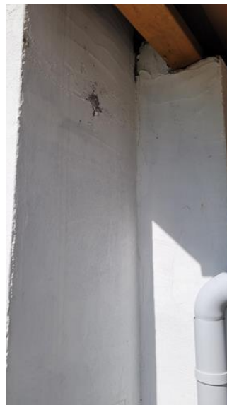
Utvendig - [Riss ved pipe i vinterhage.]
