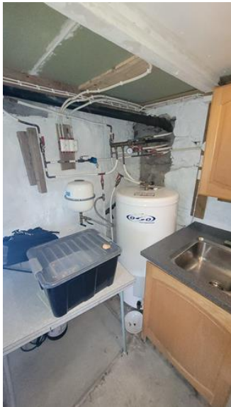
Tekniske anlegg, VVS anlegg (Sjekkpunkter utover det som er inkludert i andre rom) - [Røropplegg kjeller hovedenhet.]
