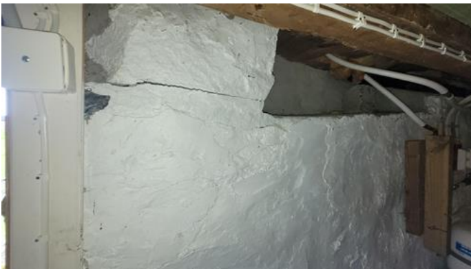
Rom under terreng (kjeller, underetasje, sokkeletasje) - [Sprekk i vegg, kjeller. 1]
