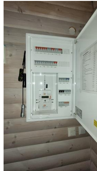
Elektrisk anlegg - [Sikringskap hovedenhet.]
