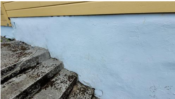
Utvendig - [Riss i yttervegg.]
