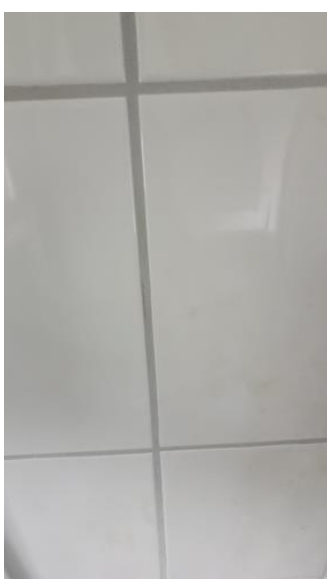
Våtrom - [Riss i flisefug.]
