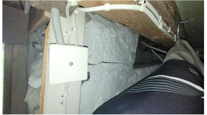
Rom under terreng (kjeller, underetasje, sokkeletasje) - [Sprekk i vegg, kjeller. 2]
