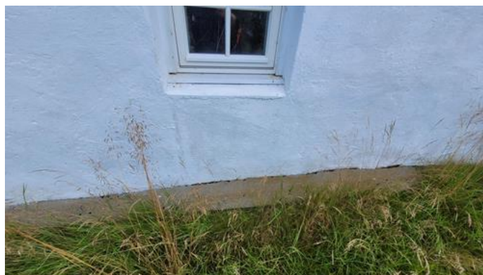
Utvendig - [Riss i yttervegg.]
