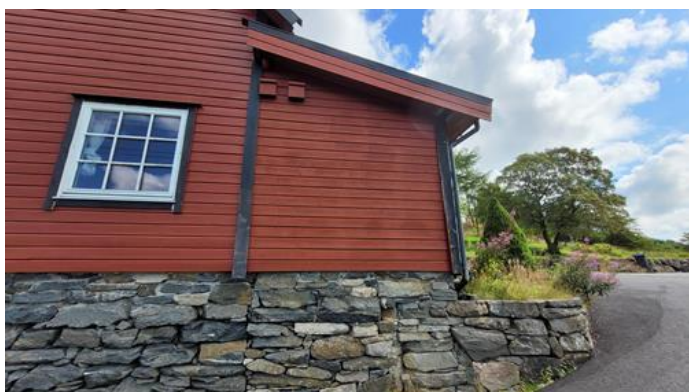
Utvendig - [Fasade har preg av slitasje.]
