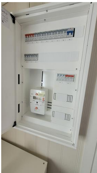
Elektrisk anlegg - [Sikringskap leilighet.]
