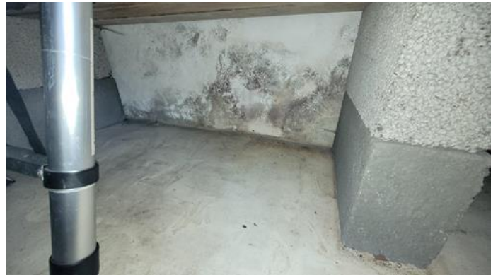
Rom under terreng (kjeller, underetasje, sokkeletasje) - [Kalkutslag på vegg i kjeller.]
