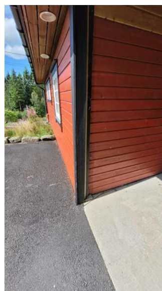
Utvendig - [Fasade har preg av slitasje.]
