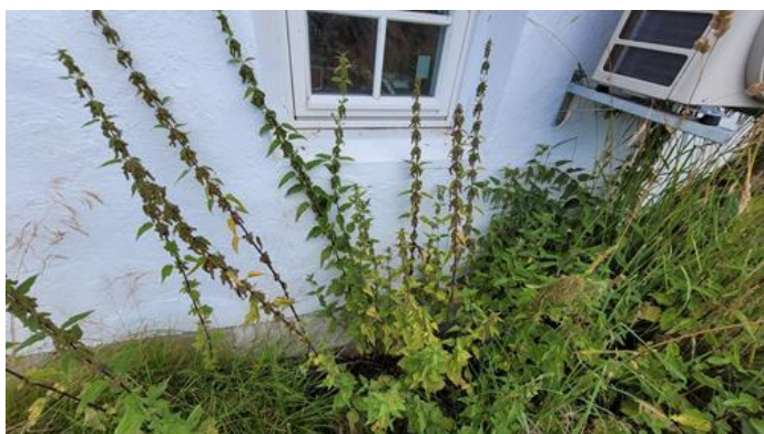
Utvendig - [Riss i yttervegg.]
