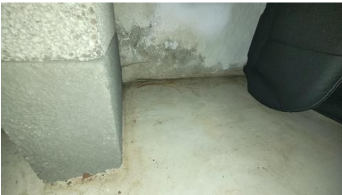
Rom under terreng (kjeller, underetasje, sokkeletasje) - [Kalkutslag på vegg i kjeller.]
