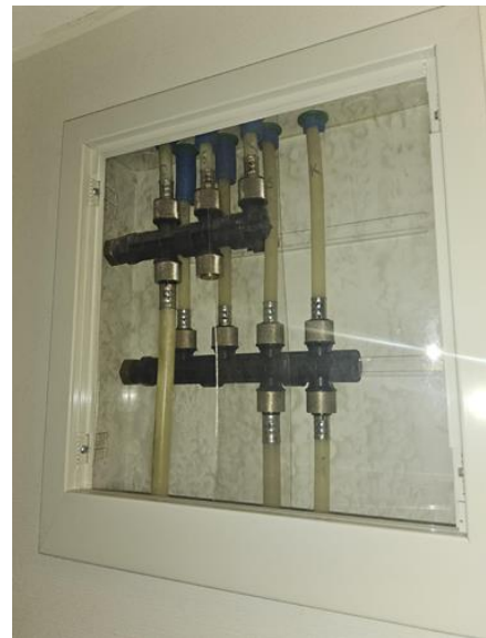
Tekniske anlegg, VVS anlegg (Sjekkpunkter utover det som er inkludert i andre rom) - [Fordelerskap for rør-i-rør-systemet]
