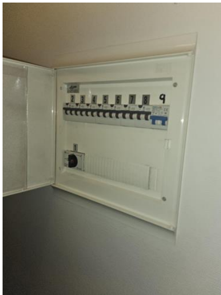
Elektrisk anlegg - [Sikringskap]
