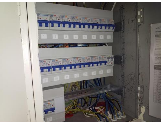
Forenklet vurdering av det elektriske anlegget - [Sikringskap 2.etasje.]
