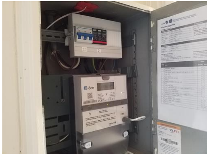
Forenklet vurdering av det elektriske anlegget - [Måler og hovedsikringer.]
