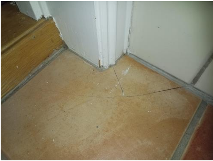
Kommentar - [Sprukket gulvflis ved dør. Bad i 1.etasje.]
