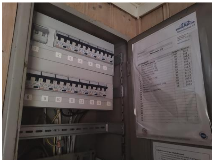
Beskrivelse - [Sikringsskap og kursfortegnelse ]
