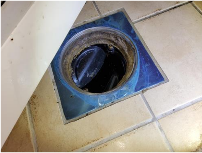
Membran, tettesjikt og overgang til sluk. - [Sluk under dusjkabinett bad mot øst]
