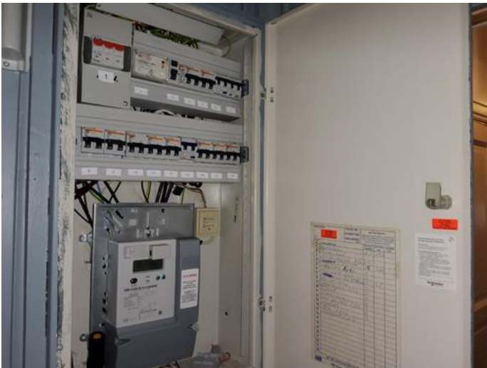
Elektrisk anlegg - [Sikringskap]
