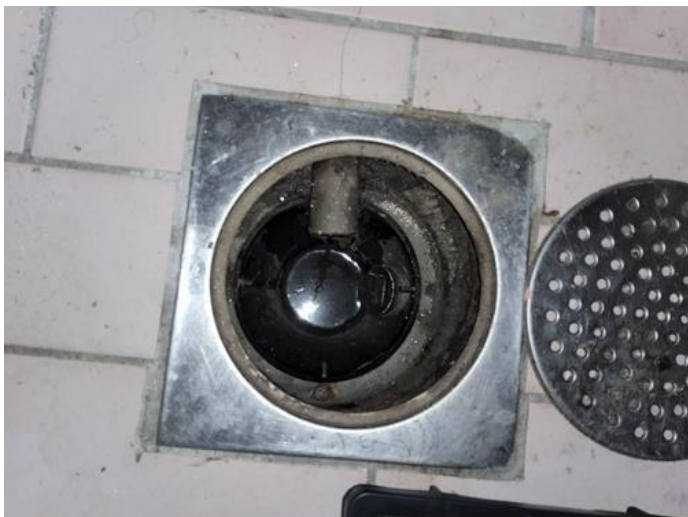
Kommentar - [Sluk vaskerom ]
