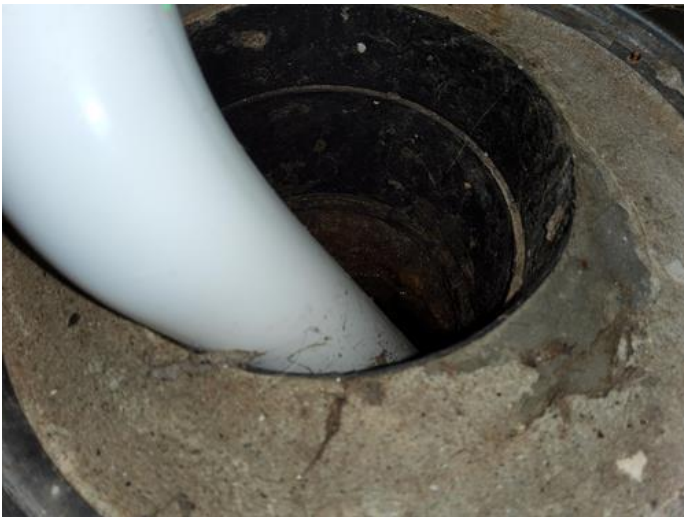
Kommentar - [Sluk bad 2.etasje ]
