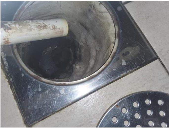
Kommentar - [Sluk bad 1.etasje ]
