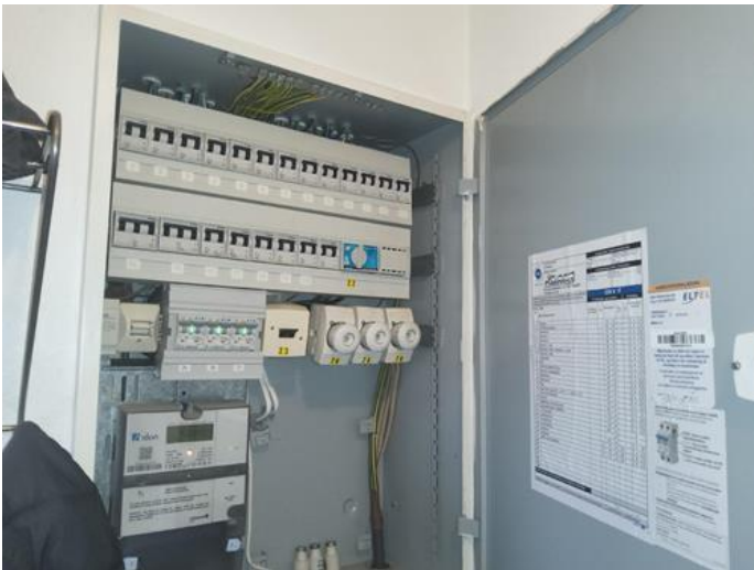
Beskrivelse - [Sikringskap og kursfortegnelse ]
