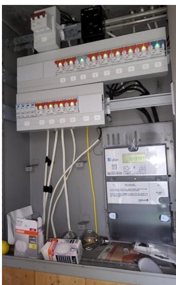
Elektrisk anlegg - [Sikringskap ]
