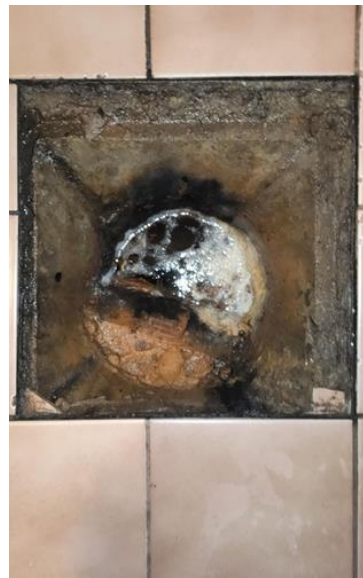
Avløpsrør (ink. sluk) - [Sluk på bad kjeller]
