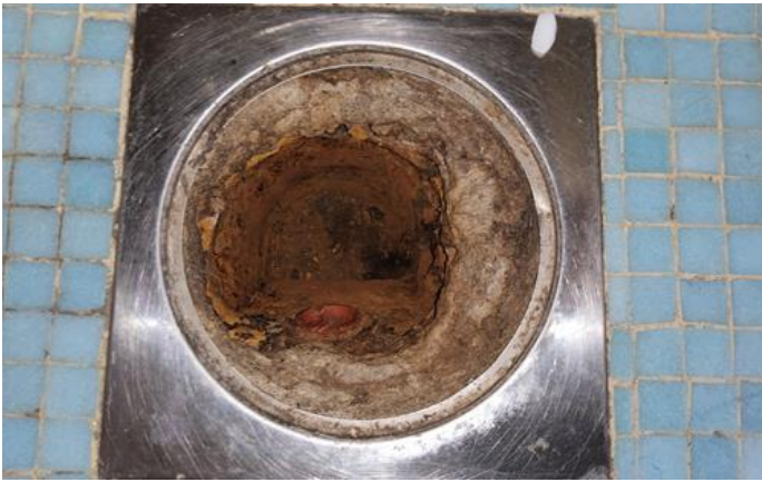
Avløpsrør (ink. sluk) - [Sluk på bad 1.etasje ]
