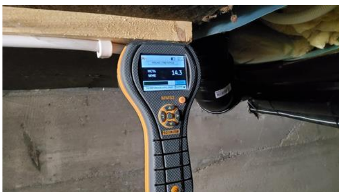
Krypekjeller - [Fuktmåling krypekjeller]
