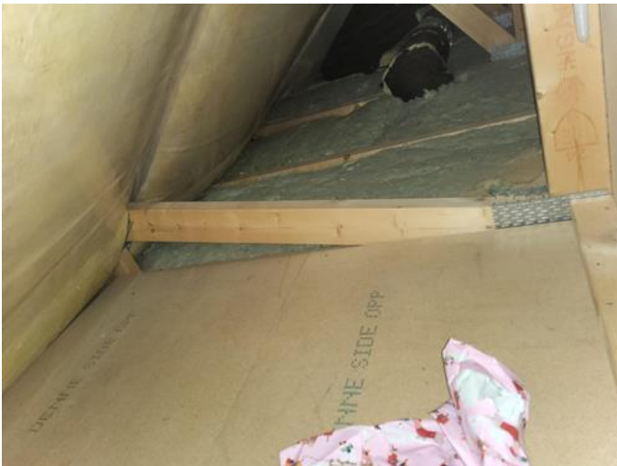
Helhetsvurdering - [Kaldloft med åpninger i dampsperre, se avsnitt kaldloft. ]
