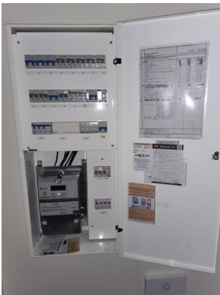
Elektrisk anlegg - [Sikringskapp ]
