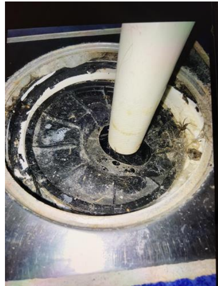
Membran, tettesjikt og overgang til sluk. - [Sluk bad med tilkomst fra kjellerstue ]
