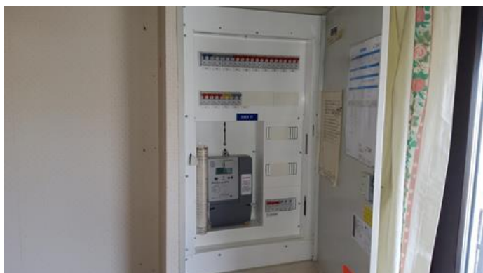
Elektrisk anlegg - [Sikringskap]
