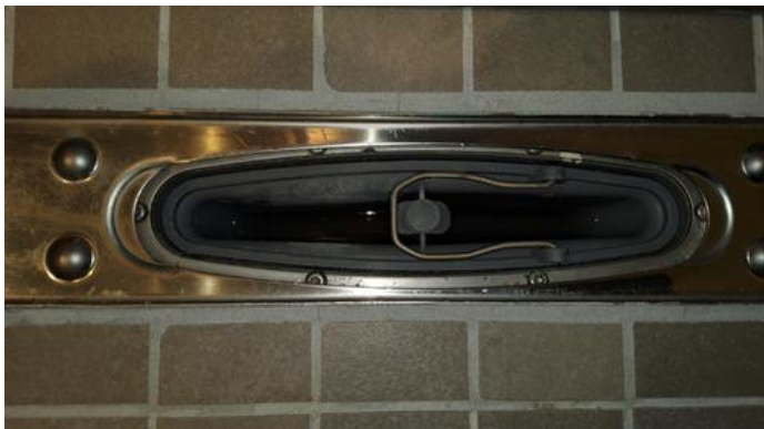
Avløpsrør (ink. sluk) - [Sluk bad 1.etg]
