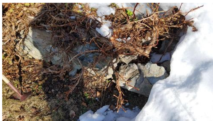
Forstøtningsmurer - [Deformasjon på støttemur]
