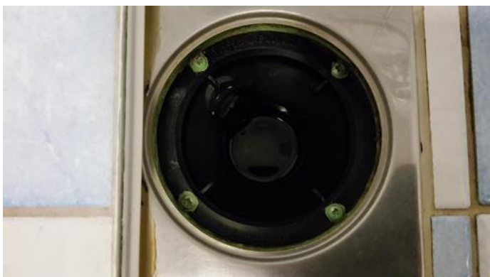
Avløpsrør (ink. sluk) - [Sluk bad u.etg]
