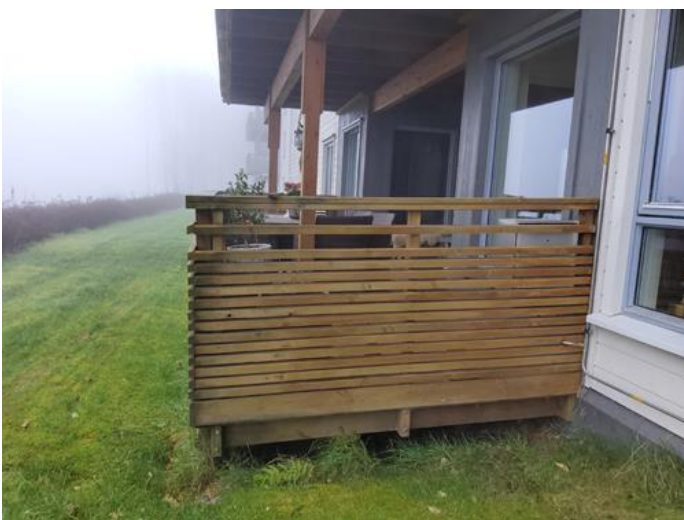
Beskrivelse - [Skjjevheter terrasse]
