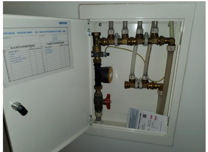
Vannrør (Sjekkpunkter utover det som er inkludert i andre rom) - [Fordelerskap]
