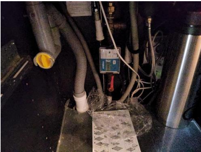
Tekniske anlegg, VVS anlegg (Sjekkpunkter utover det som er inkludert i andre rom) - [Hovedstoppekran og vannmåler plassert i benkeskap.]
