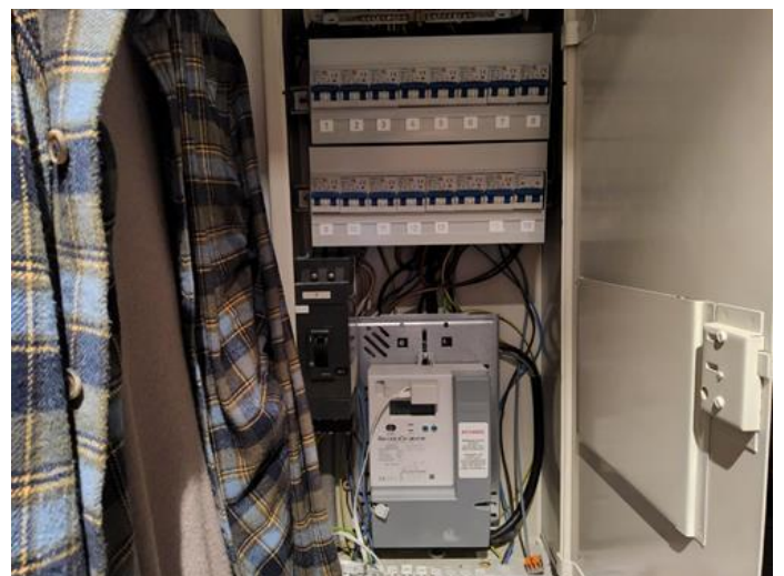
Elektrisk anlegg - [Sikringskap plassert i entre.]
