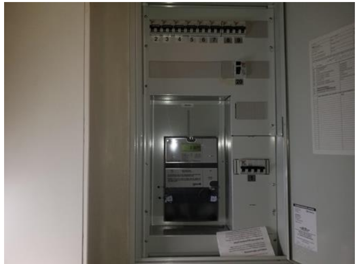
Elektrisk anlegg - [Sikringskap. ]
