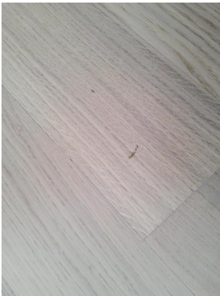
Kommentar - [Skade forran komfyr]
