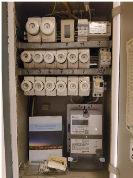
Elektrisk anlegg - [Sikringsskap ]
