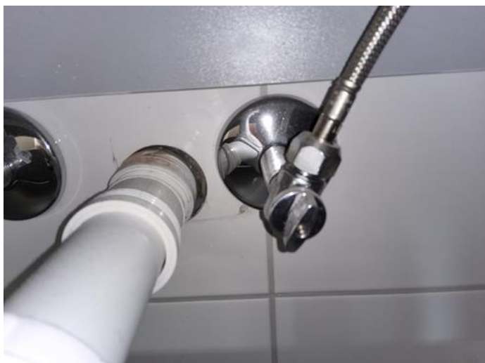
Overflater vegger - [Sprektflis på vegg/ tettedetaljer avløpsrør]
