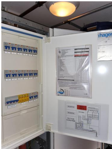
Elektrisk anlegg - [Sikringskap ]
