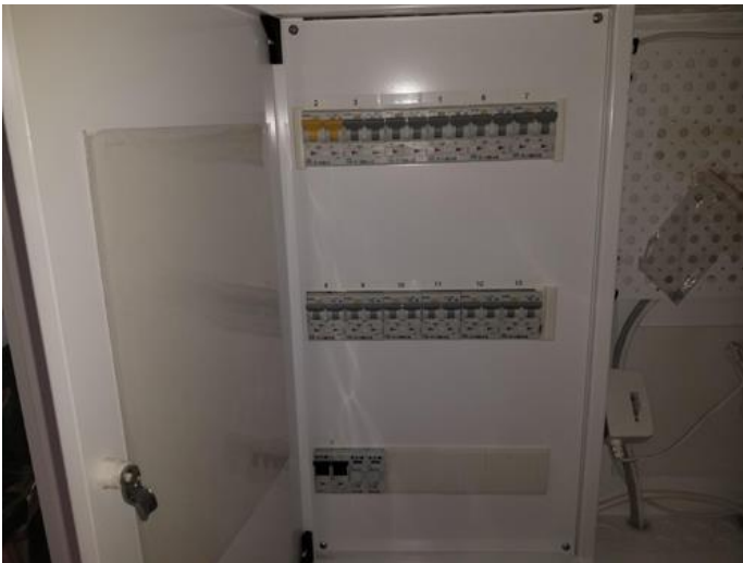
Elektrisk anlegg - [Sikringsskap.]
