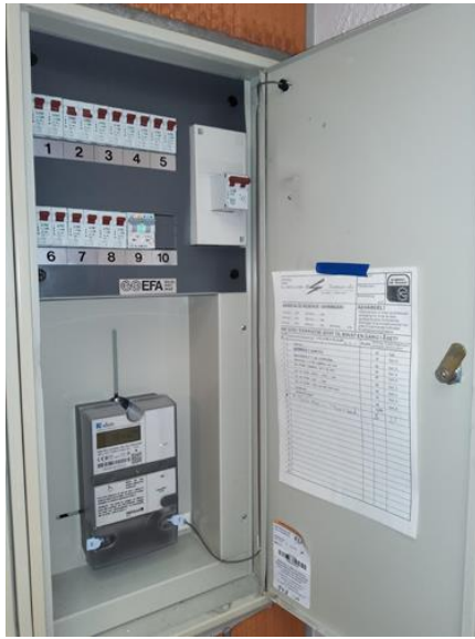
Elektrisk anlegg - [Sikringskap ]
