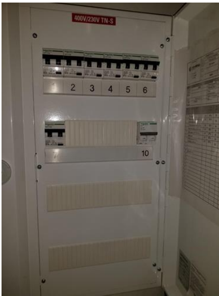
Elektrisk anlegg - [Sikringskap]
