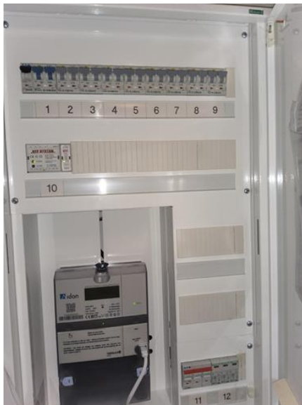
Elektrisk anlegg - [sikringskap]
