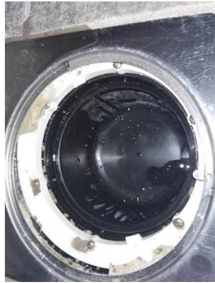
Tekniske anlegg, VVS anlegg (Sjekkpunkter utover det som er inkludert i andre rom) - [sluk kjeller]
