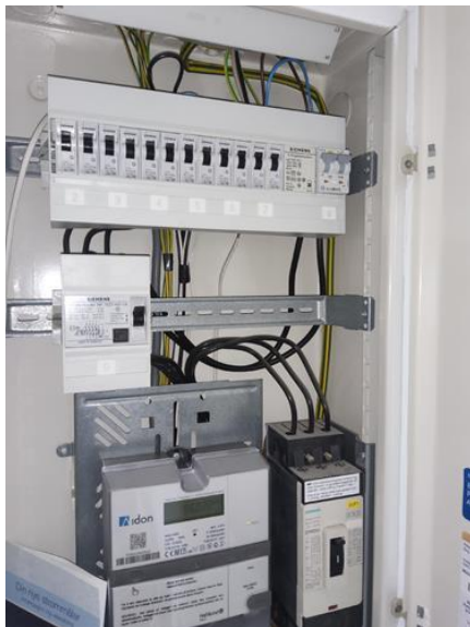
Elektrisk anlegg - [Sikringskap ]
