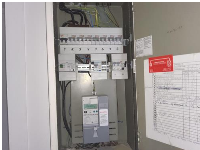
Elektrisk anlegg - [Sikringskap ]
