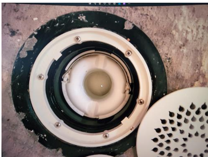
Våtrom - [Sluk på vaskerom/kjeller ]
