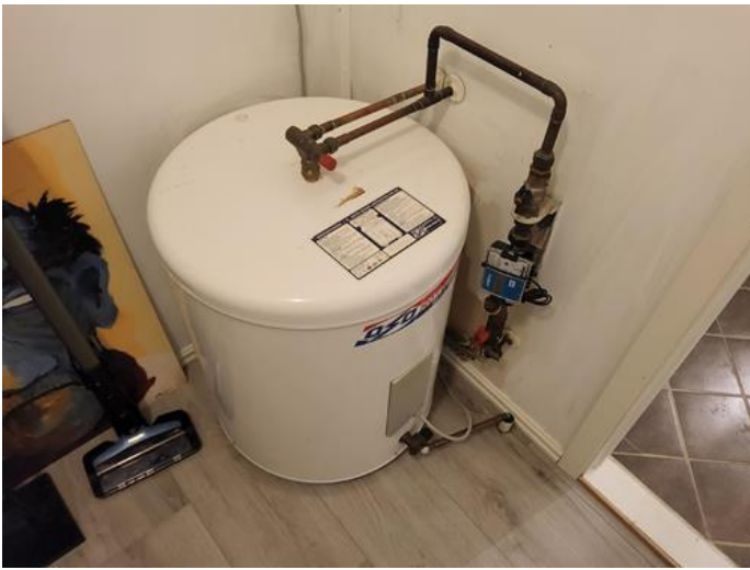
Tekniske anlegg, VVS anlegg (Sjekkpunkter utover det som er inkludert i andre rom) - [Varmtvannsbereider, stoppekran og vannmåler]
