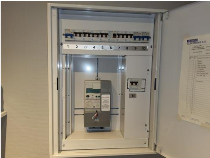
Elektrisk anlegg - [Sikringsskap]
