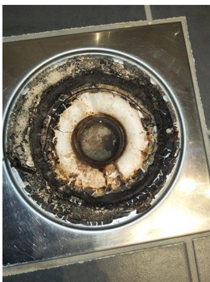
Våtrom - [Sluk bad underetasje]
