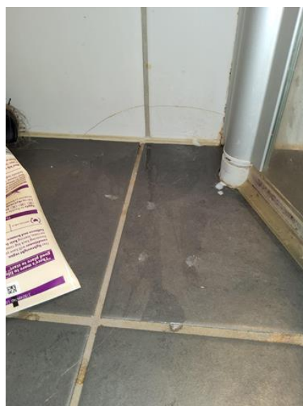
Overflater vegger - [Riss/sprekker i veggfliser i dusjsonen, bad underetasje]
