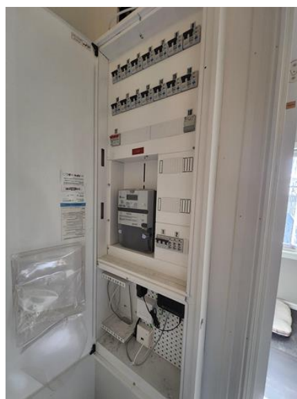
Elektrisk anlegg - [Sikringsskap]
