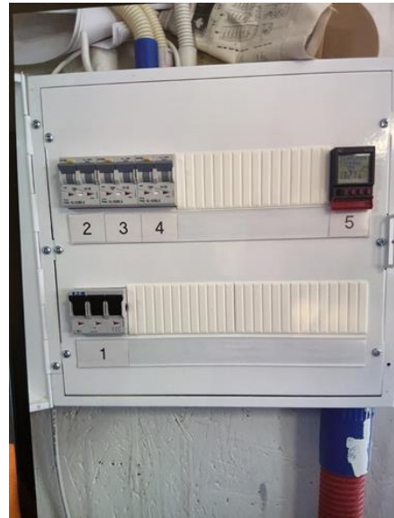
Elektrisk anlegg - [Sikringsskap garasje ]
