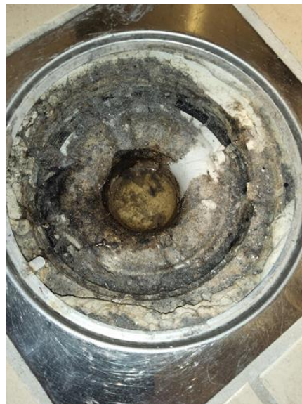
Våtrom - [Sluk vaskerom]
