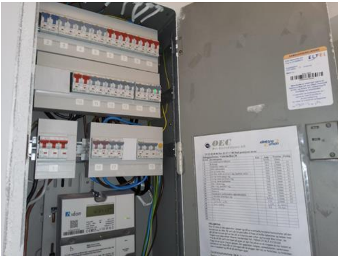
Beskrivelse - [Sikringskap med kursfortegnelse.]
