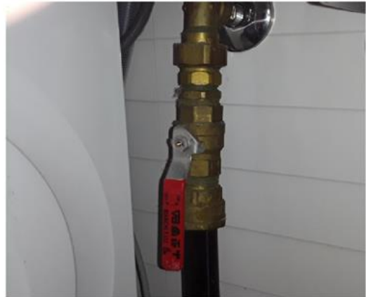
Tekniske anlegg, VVS anlegg (Sjekkpunkter utover det som er inkludert i andre rom) - [Stoppekran - Vaskerom]
