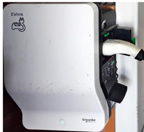
Elektrisk anlegg - [Billader - Garasje]
