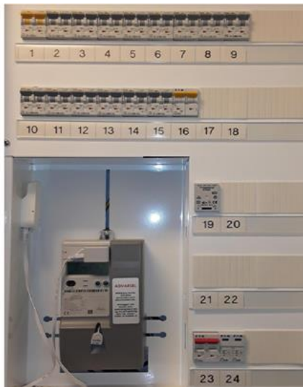
Elektrisk anlegg - [Sikringskap - Bod]
