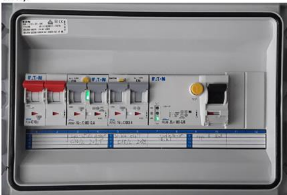
Elektrisk anlegg - [Sikringskap og kursfortegnelse - Garasje]
