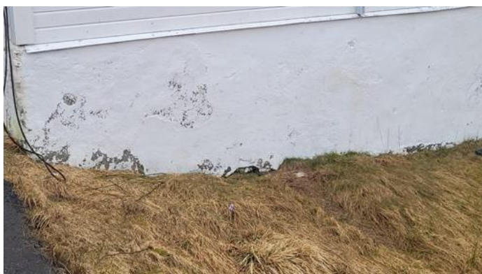
Yttervegger inkl. fasader og konstruksjon - [Malingsavskalling.]
