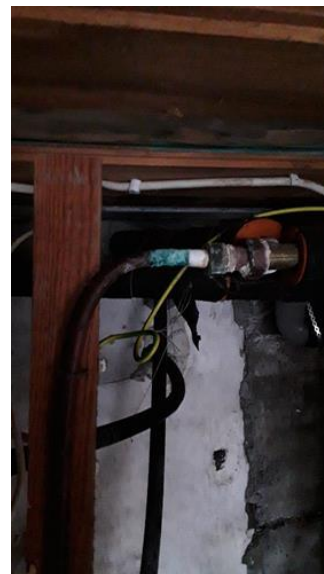
Vannrør (Sjekkpunkter utover det som er inkludert i andre rom) - [Kobberør er sterkt alderspreget.]
