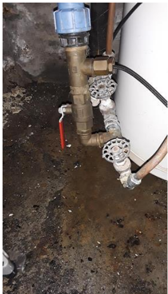
Vannrør (Sjekkpunkter utover det som er inkludert i andre rom) - [Vannlekkasje.]
