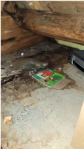
Loft - uinnredet / råloft - [Lekkasje ved pipe.]
