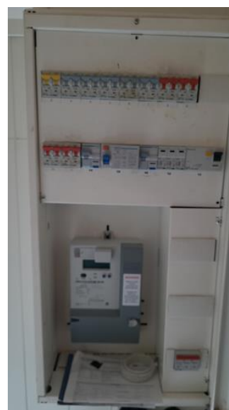
Elektrisk anlegg - [Sikringskap]
