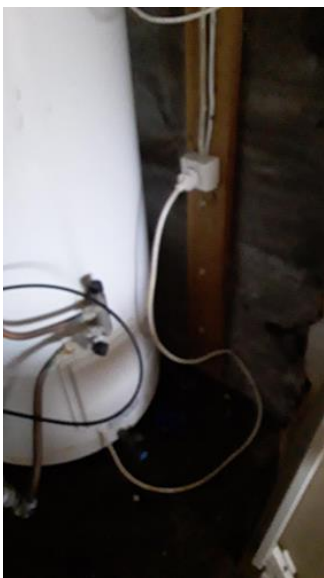
Elektrisk anlegg - [Stikkontakt varmtvannsbereider.]
