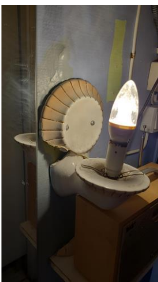
Elektrisk anlegg - [Skadet armatur til lys.]
