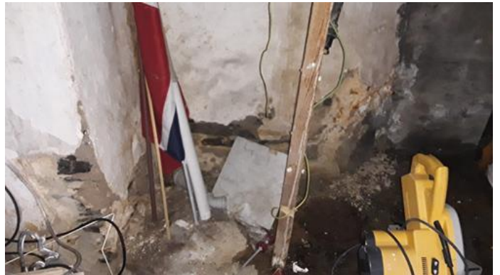
Rom under terreng (kjeller, underetasje, sokkeletasje) - [Saltutslag/fukt i kjeller, inn til krypkjeller.]
