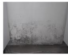
Rom under terreng (kjeller, underetasje, sokkeletasje) - [Fuktmerker-svertesopp på yttervegg i kjøkken - Underetasje]
