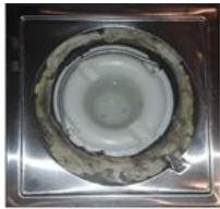
Våtrom - [Sluk - Bad 1. etasje]
