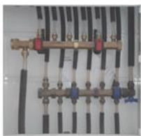
Tekniske anlegg, VVS anlegg (Sjekkpunkter utover det som er inkludert i andre rom) - [Fordelerskap til rør-i-rør system]
