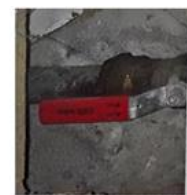
Tekniske anlegg, VVS anlegg (Sjekkpunkter utover det som er inkludert i andre rom) - [Stoppekran inne i vegg - Bad]
