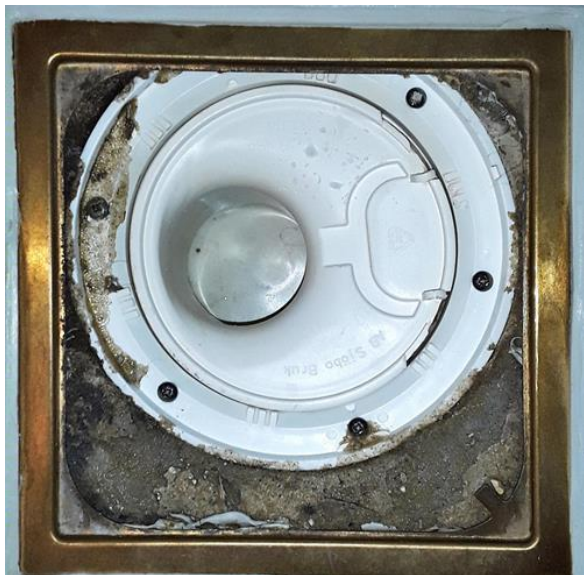
Våtrom - [Sluk bad 1. etasje]
