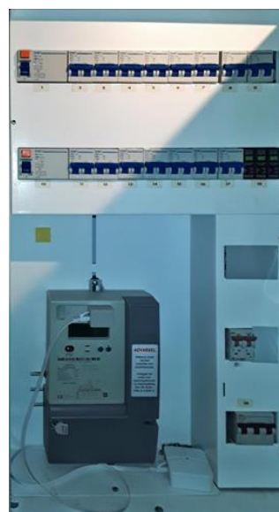
Elektrisk anlegg - [Sikringssskap]
