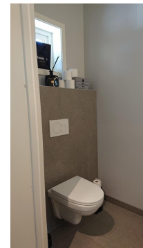
Vegghengt toalett med flis på innebygget sisternes vegg.
