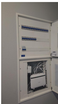
El.skap med god standard fra byggeår.
