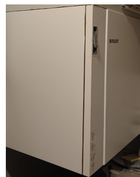
Balansert ventilasjon. Flexit aggregat plassert på vegg i bod i 2.etasje.
