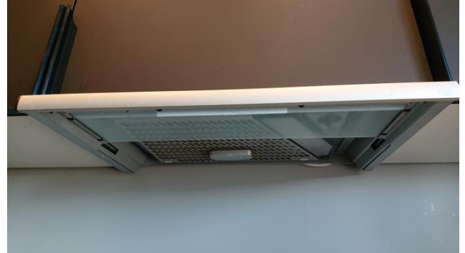
Kjøkkenventilator med avtrekk ut i yttervegg.
