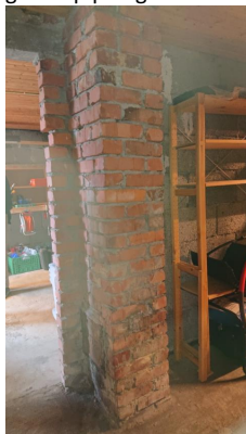
Teglsteinspipe fra byggeår. Liten innvendig diameter.
