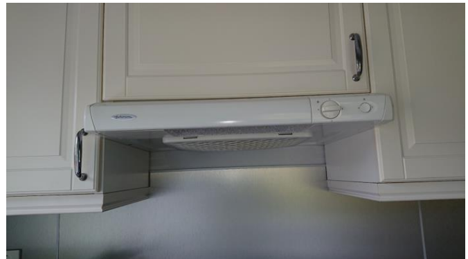
Kjøkkenventilator ble testet. Ok.
