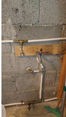
Vannledninger i kobber med plastkappe.
