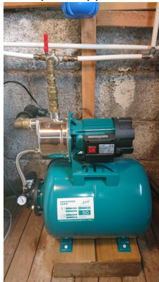
Stoppekraner er lette tilgjengelige.
