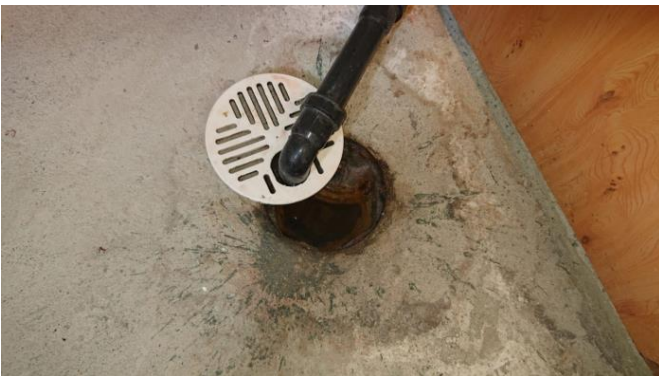
Stålsluk fra byggeår i gulv på teknisk rom.
