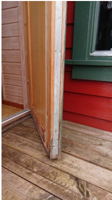
Slitt dørbblad til altandør. Svake tegn til råte.
