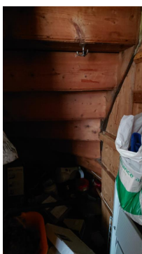
Bod under trapp som har tette trinn.
