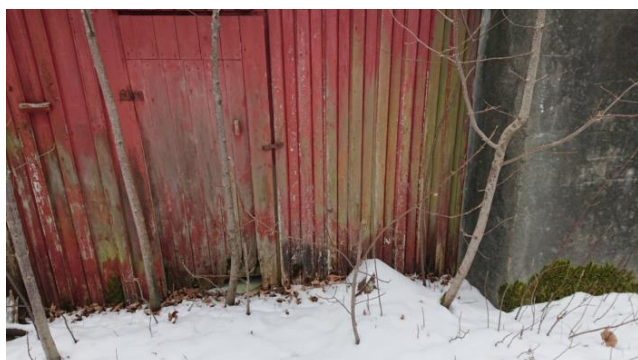
Råte i kledning på yttervegger flere steder.
