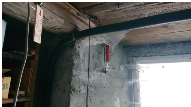
Mit og råteskadede trevirke i bjelkelag og gulvbord flere steder, synlig fra kjeller.
