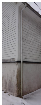
Grunnmur bør repareres, vaskes og overflatebehandles.
