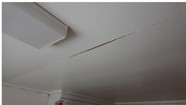
Sprekker i tak på kjøkken.
