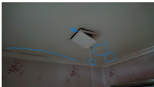
Diverse fuktskader i tak.
