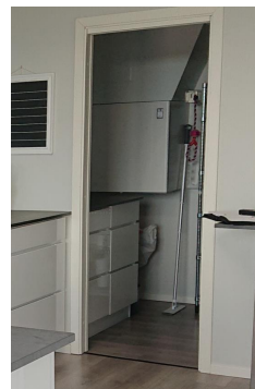
Flexit aggregat CI60 til balansert ventilasjon var plassert i bod i 2.etasje.
