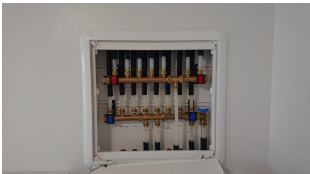
Rør-i-rør skap var plassert på vaskerom.
