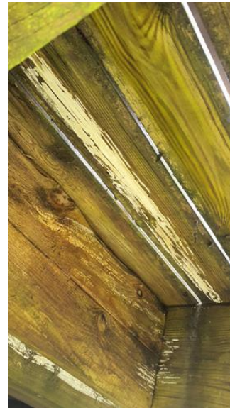
Balkonger, terrasser, veranda etc - [Råteskader på balkong]
