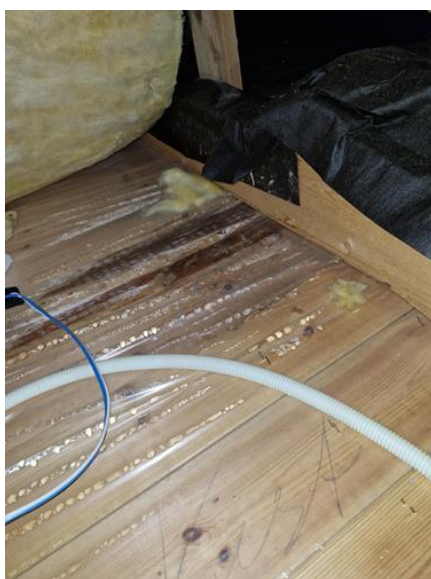
Loft - uinnredet / råloft - [Synlig kondens mellom dampsperre og himling]
