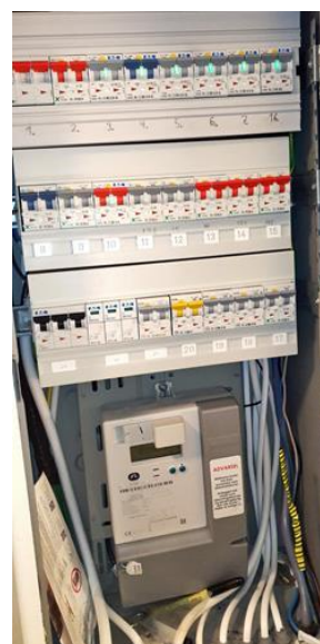
Elektrisk anlegg - [Sikringsskap]
