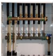
Tekniske anlegg, VVS anlegg (Sjekkpunkter utover det som er inkludert i andre rom) - [Fordelerskap til rør-i-rør system]
