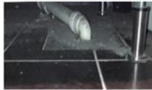
Våtrom - [Sluk under innredning - Vaskerom]
