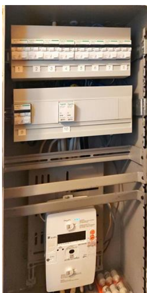
Elektrisk anlegg - [Sikringsskap]
