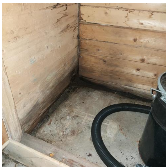
Rom under terreng (kjeller, underetasje, sokkeetasje) - [Råteskade]
