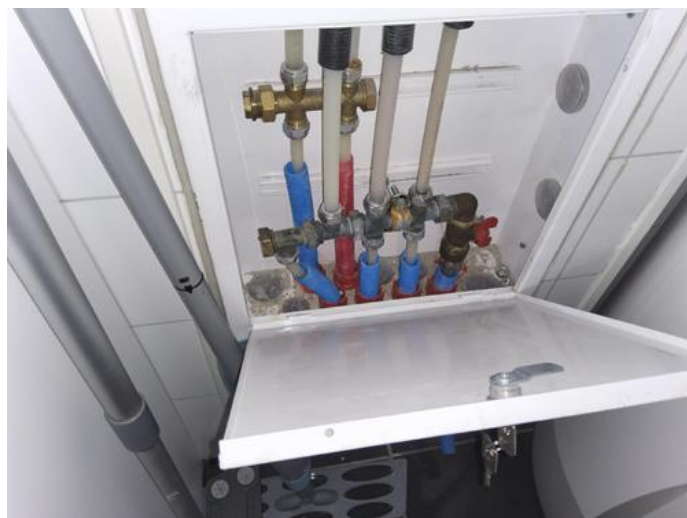
Vannrør - [Fordelerskap hybel ]
