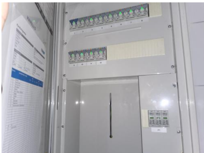
Beskrivelse - [Sikringsskap hybel ]
