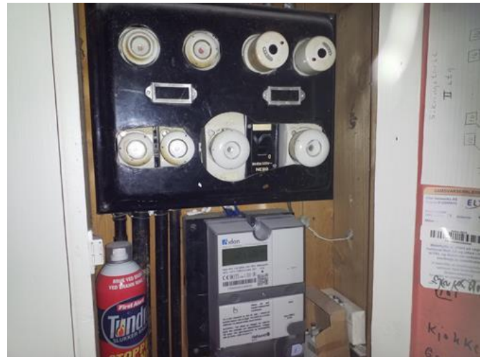
Forenklet vurdering av det elektriske anlegget - [Sikringskap.]
