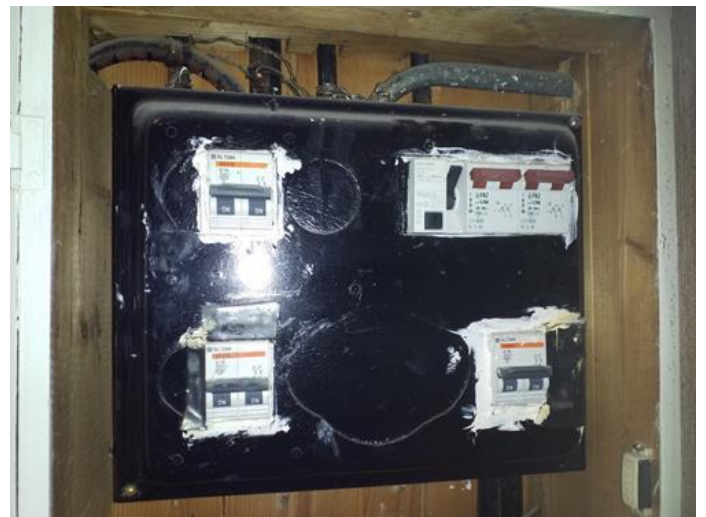
Forenklet vurdering av det elektriske anlegget - [Sikringskap. 1.etasje.]
