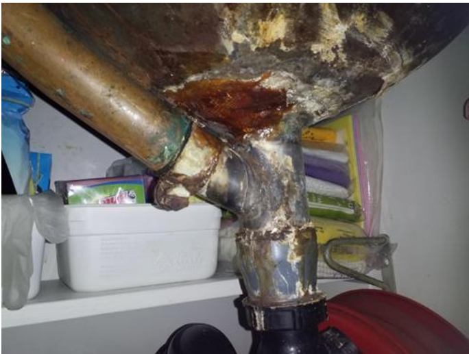
Sjablommessig prisanslag - [Skadet feste for utslagsvask i kjøkken.]
