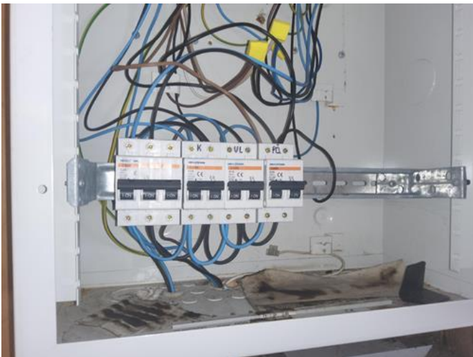
Elektrisk anlegg - [Sikringsskap i garasjen. ]
