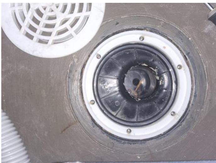
Overflater gulv - [Sluk i gulv på teknisk rom. ]
