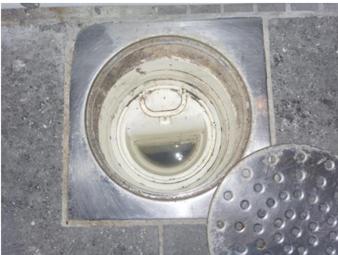
Avløpsrør (ink. sluk) - [Sluk på bad underetasje. ]
