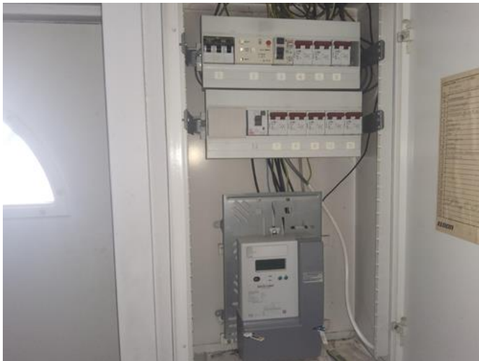
Elektrisk anlegg - [Sikringsskap i underetasje. ]
