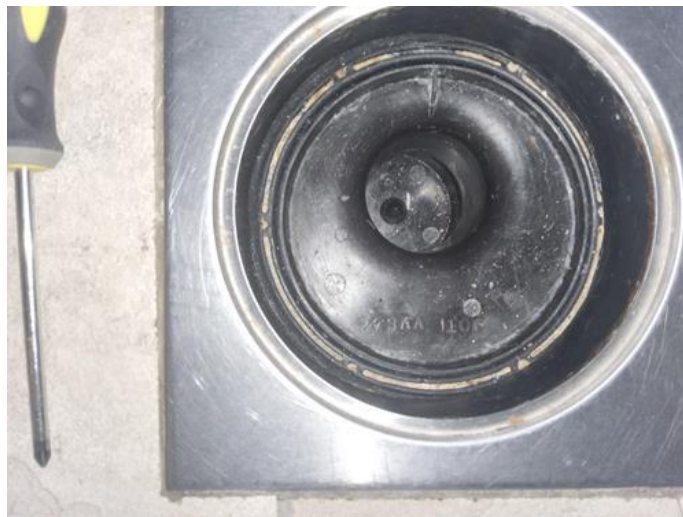
Avløpsrør (ink. sluk) - [Sluk på vaskerom. ]
