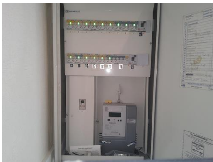
Elektrisk anlegg - [Sikringskap 1.etasje. ]
