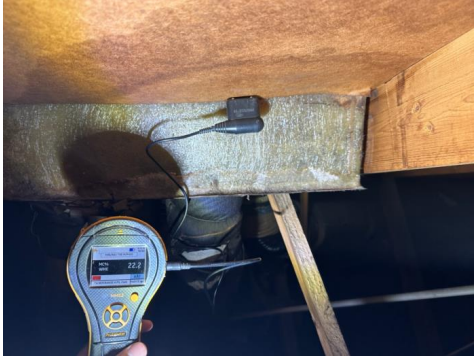
Lekkasje på loft er under utbedring (utbedret årsak)
