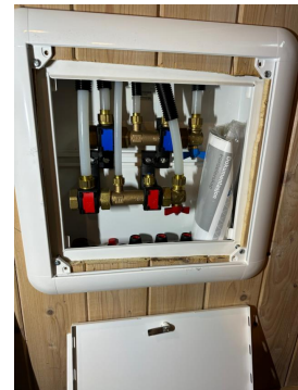
Rørskap i kjeller med 2 x stoppekraner-uten kursmerking
