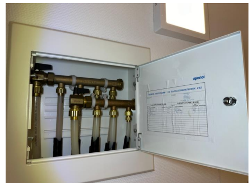
Rørskap i 1 etg med 2 x stoppekraner
