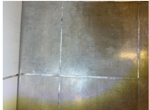
Kalkutslag i flisefuger i dusjsone.
