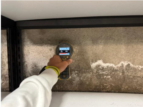
Fuktgjennomslag i kjellebod
