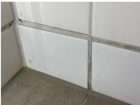
Riss/sprekker i nedre fliserad
