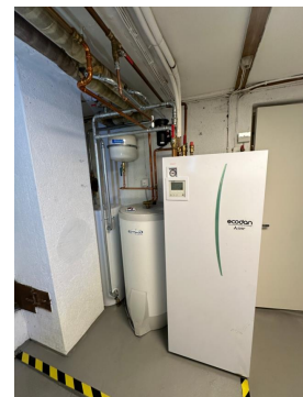
Beredere og trykktank plassert i hjørne av vaskerom
