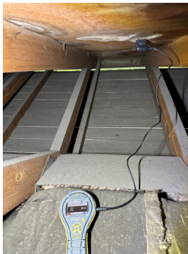
Lekkasje på loft er under utbedring (utbedret årsak)
