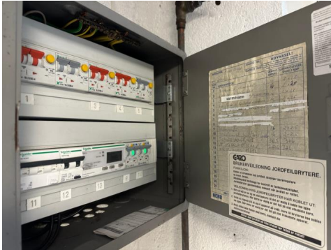
Elskap i vaskerom 1
