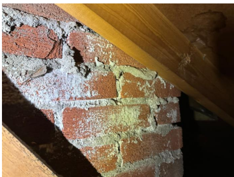
Noe saltutslag på pipestamme
