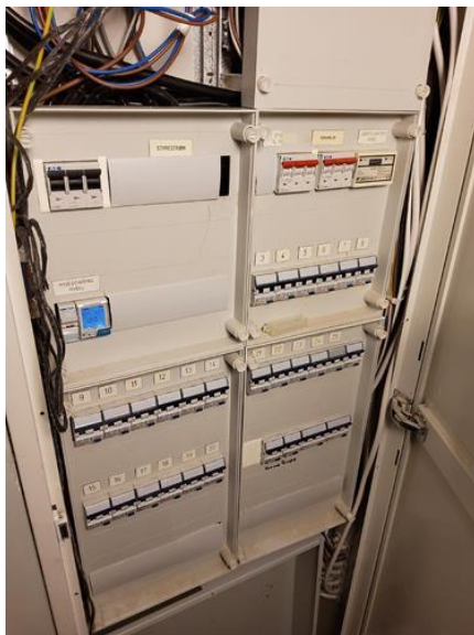
Elektrisk anlegg - [Sikringskapp]
