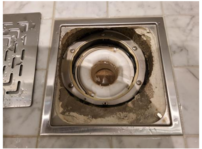
Membran, tettesjikt og overgang til sluk. - [Sluk baderom med adkomst fra trappegang]
