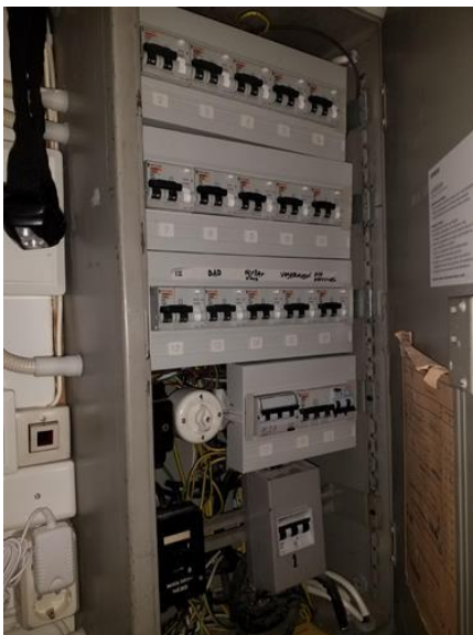
Elektrisk anlegg - [Sikringskap hoveddel ]
