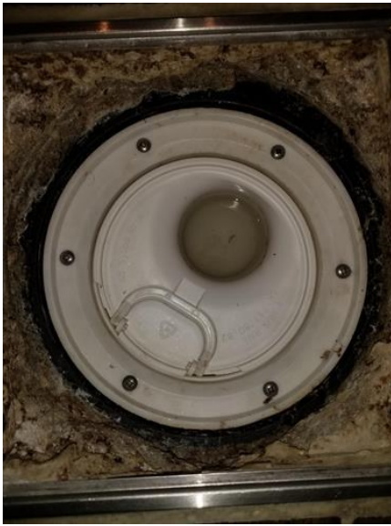
Membran, tettesjikt og overgang til sluk. - [Sluk bad underetasje ]
