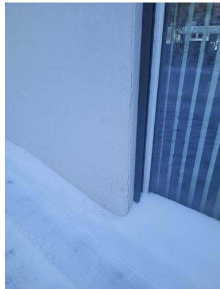
Fasader ink. kledning - [Riss vegg ved stue]
