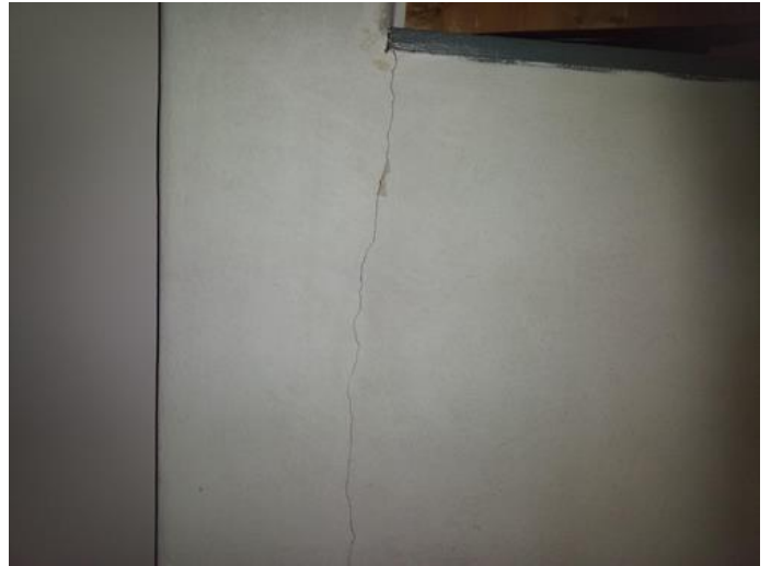
Kommentar - [Sprekk i grunnmur i kjeller.]
