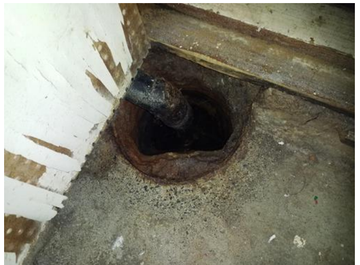
Helhetsvurdering - [Sluk i vaskerom. Kjeller.]
