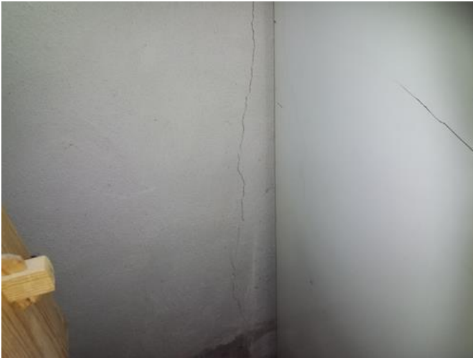
Kommentar - [Sprekk i grunnmur.]
