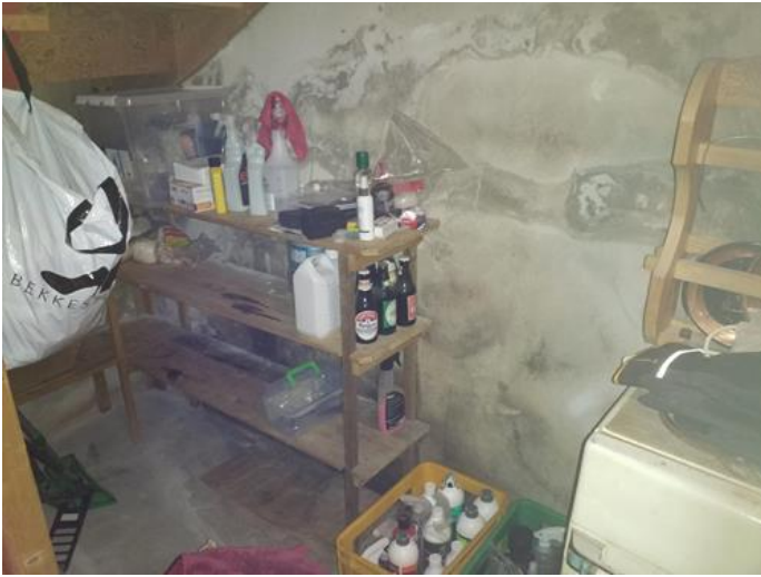
Kommentar - [Saltutslag/fuktmerker på vegg i kjeller.]
