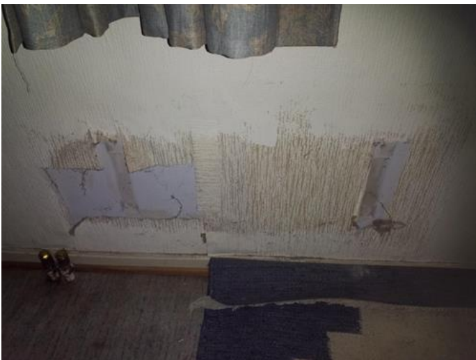
Kommentar - [Slitasje på vegg i rom benyttet som kjellerstue.]
