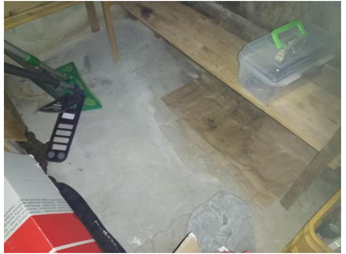
Kommentar - [Saltutslag/fuktmerker i kjeller.]
