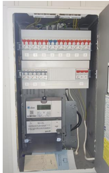
Elektrisk anlegg - [Sikringskap]
