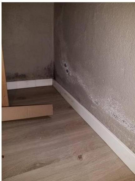
Konstruksjoner (tilfarergulv, himling og vegger). - [Saltutslag kjeller]
