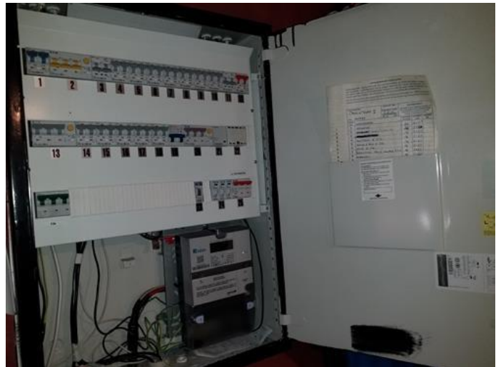
Elektrisk anlegg - [Sikringsskap 1.etasje]
