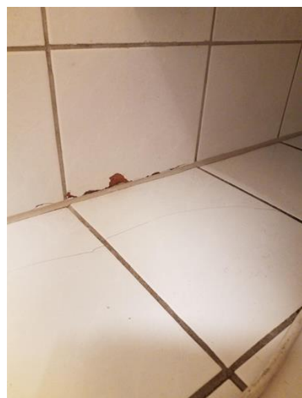
Overflater gulv - [Sprekt/løse fliser gulv + avskalling veggfliser]
