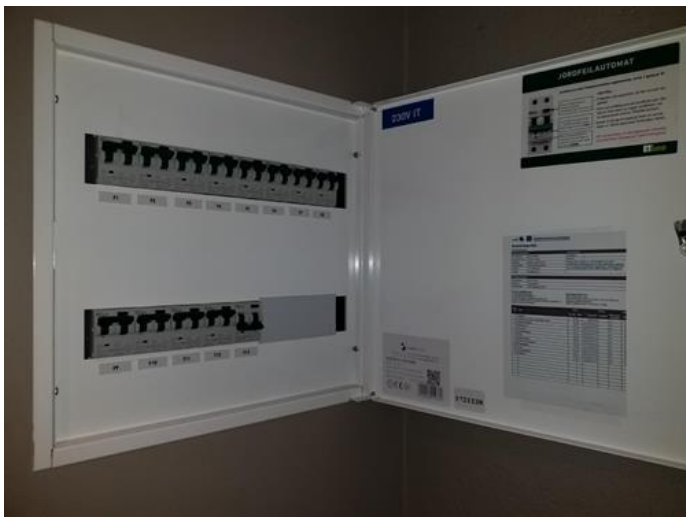
Elektrisk anlegg - [Sikringsskap kjeller]
