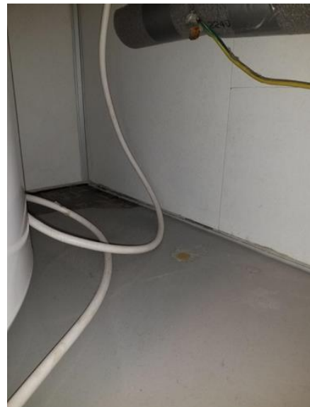
Overflater vegger - [Stedvis manglende vedheft fug, bad kjeller]
