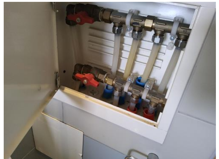
Vannrør - [Fordelerskap bad 2.etasje ]
