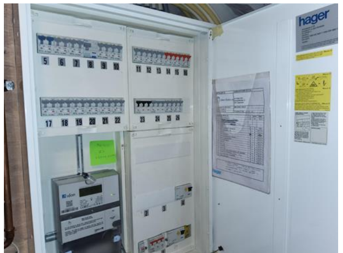
Beskrivelse - [Sikringskap og kursfortegnelse ]
