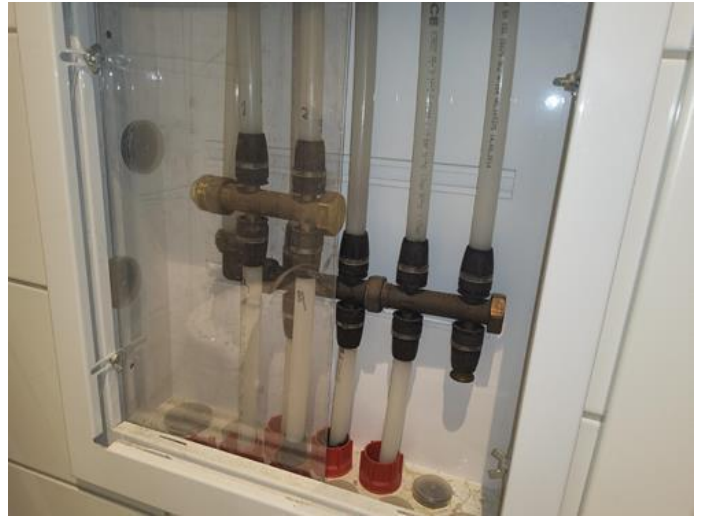
Vannrør - [Fordelerskap for rør-i-rør hybel ]
