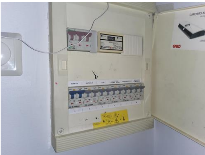
Beskrivelse - [Sikringskap hybel ]
