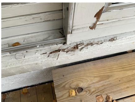
Noe skade på skyvedør i stue i 1.etg
