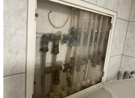
Koblingsskap på vaskerom
