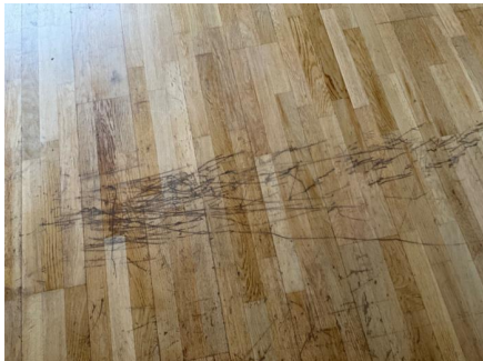
Parketten i stuen i 1.etg er utslitt
