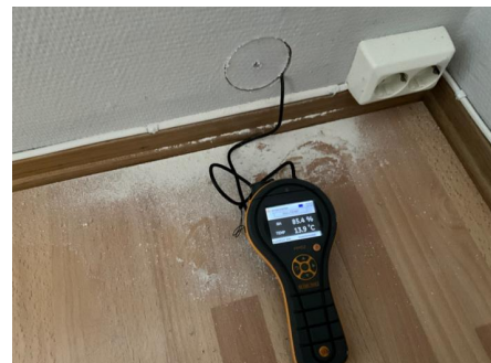
Skadelighøy fukt 85,4% RH
