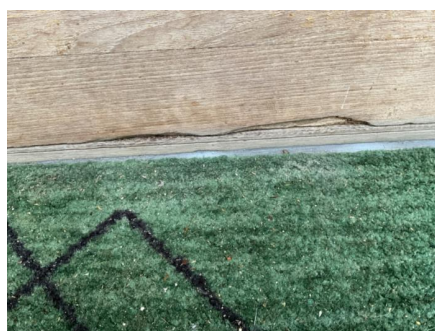
Skade på dør u.etg
