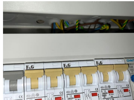
Åpent hull i sikringskap representerer brannfare
